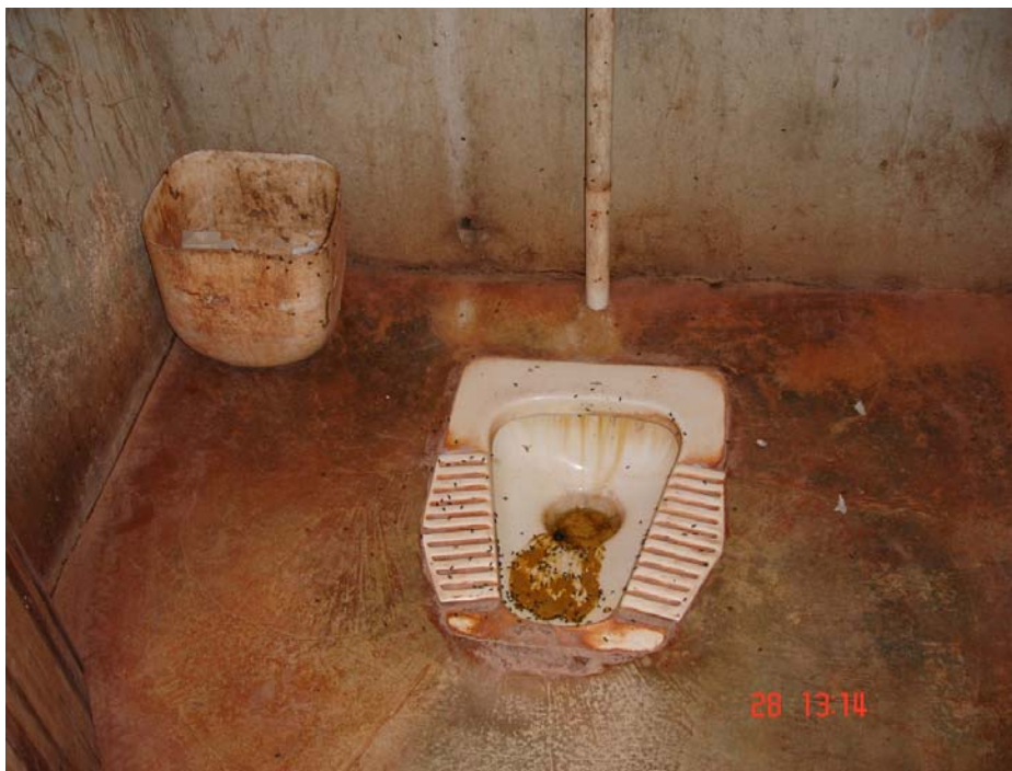
Foto 08 – Sanitário de um dos alojamentos cuja descarga não funcionava
